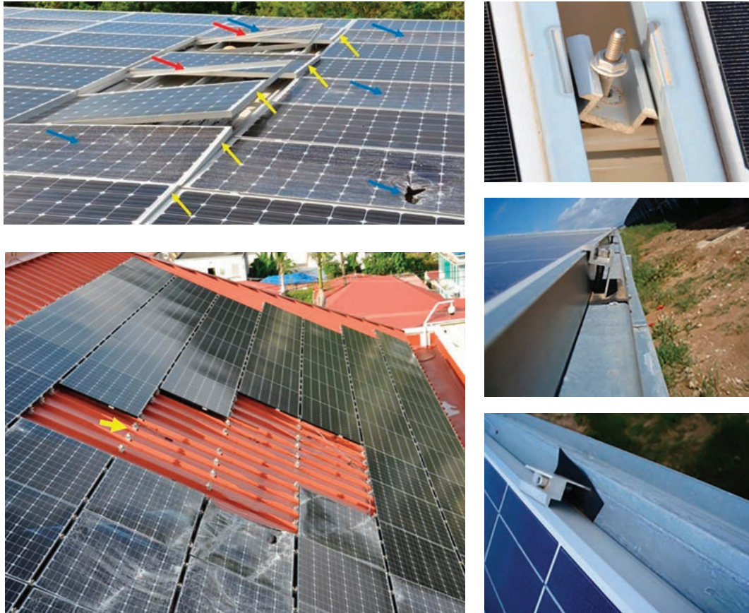
Ilustración 34: Ejemplos de daños por montaje deficiente de módulos FV y corrosión de elementos de sujeción
