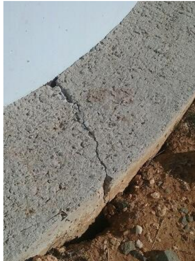
Figura 23: Daños en cimentación.
