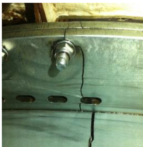
Figura 18: grietas en rodamiento de pala.
